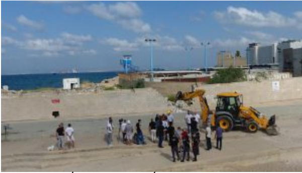
הריסת חומת בסיס חיל הים בבת גלים בחיפה. צילום דוברות עיריית חיפה
